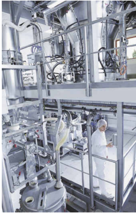
Die Wirbelschichtanlage von Sternmaid: Dank der hochmodernen Anlage ist der Lohnhersteller bestens für die Optimierung funktioneller Inhaltsstoffe aufgestellt
